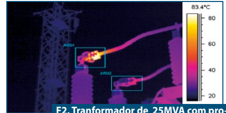
F2. Tranformador de 25MVA com problema na conexão de entrada.
