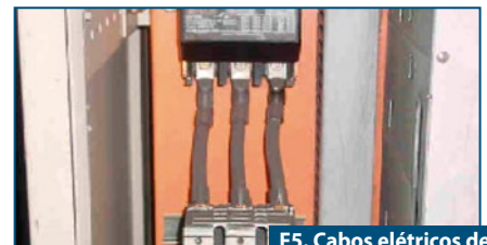
F5. Cabos elétricos de instalação.
