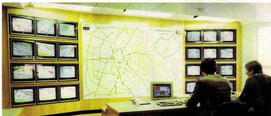
Sala de controle com monitores, na cidade de Leicester, Inglaterra.
