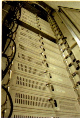
Servidores e Rack
