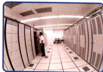
Data Center Plug In em São Paulo.
