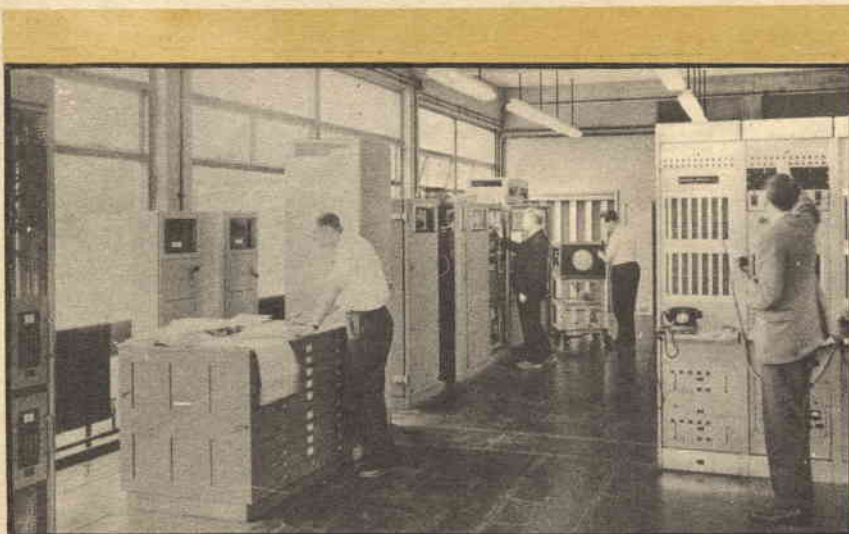
Nella stanza di equipaggiamento si trovano l'impianto terminale dei due radar di sorveglianza, il sistema di atterraggio strumentale (ILS), l'impianto di registrazione magnetica e l'impianto terminale a linea standard (a destra nella foto).
