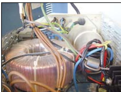
Vista del trasformatore toroidale.
