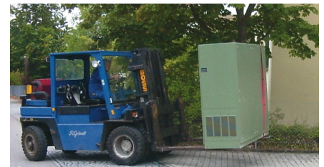
Oben: Installation der Grossrechner-Infrastruktur, darunter die aufgebauten Großrechner. Unten: Ein Stapler half beim Umzug.
