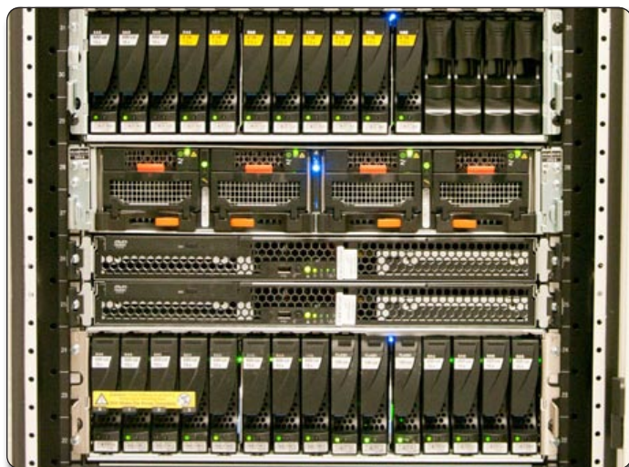
Figura 3. Storage montado em rack, visão frontal
