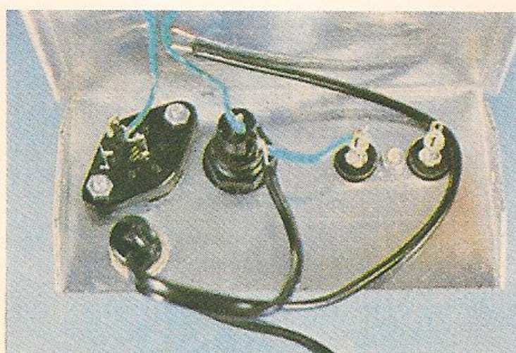
20. Ligação entre o porta-fusíveis e a tomada. Ligação do cabo de força e de fios no porta-fusíveis e na chave seletora.
