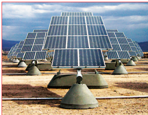
Alcuni pannelli fotovoltaici installati alla base Nellis Air Force in Nevada: un tipico sito di installazione dove la tecnica di pulizia automatica dalla polvere si dimostra vincente.
