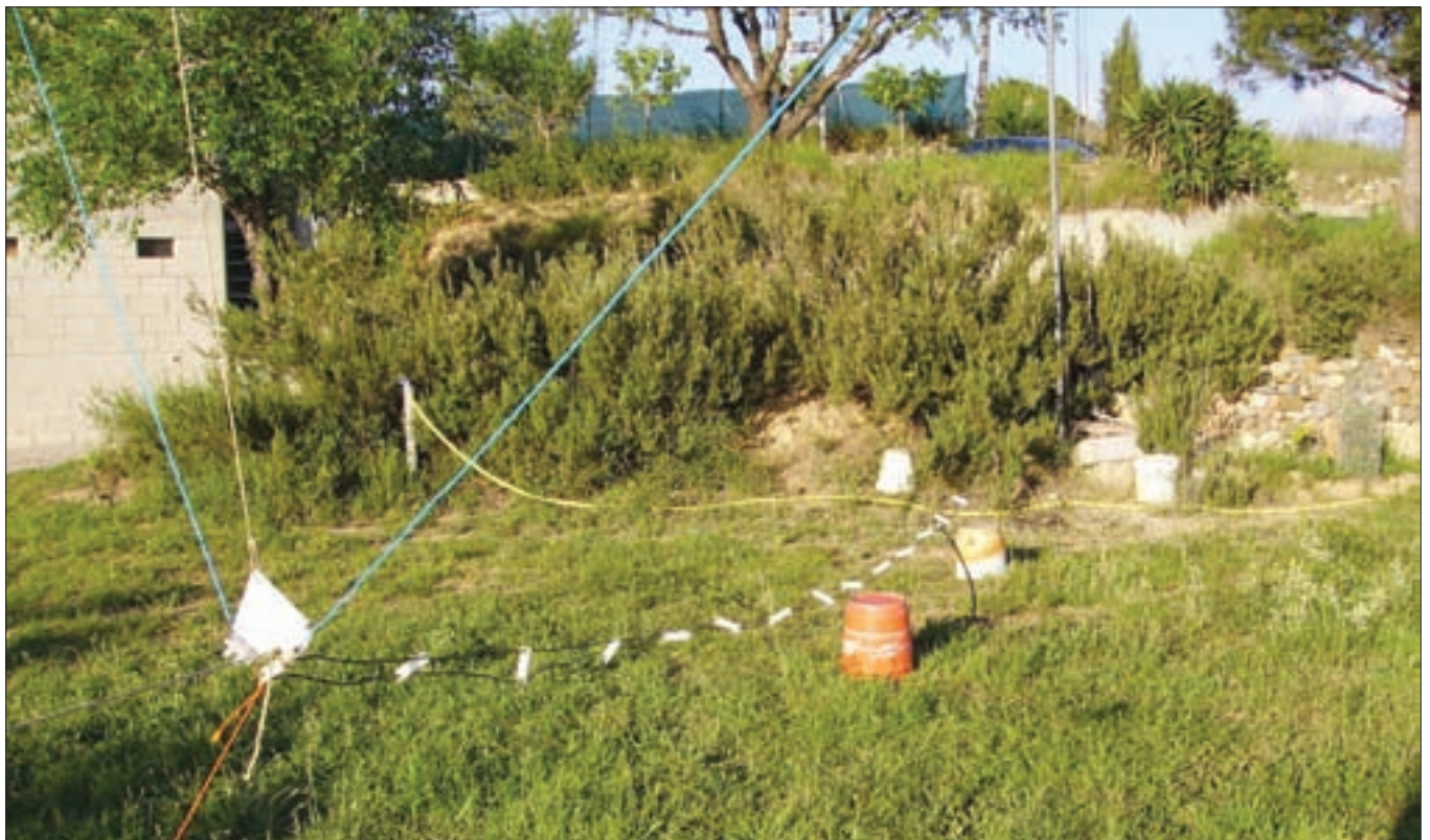
Debido a que no pudimos izar la antena hasta los 19 m proyectados, instalamos la línea de 1/4 de onda paralela al suelo. Próximo al extremo alejado se aprecia el cable coaxial que la alimenta.
