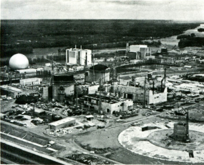
En la construcción de la central nuclear de Fessenheim (Alemania Occidental), se utilizaron microcomputadores para el control remoto de las operaciones de ensayos y pruebas.
