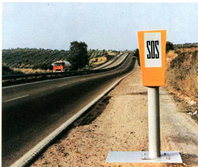
Sistema para llamadas de auxilio en carretera. Los postes se colocan a distancias adecuadas, dispuestos para ser utilizados en caso de necesidad. Están conectados todos ellos a una central de radio-frecuencia en donde se recogen todas las llamadas.
