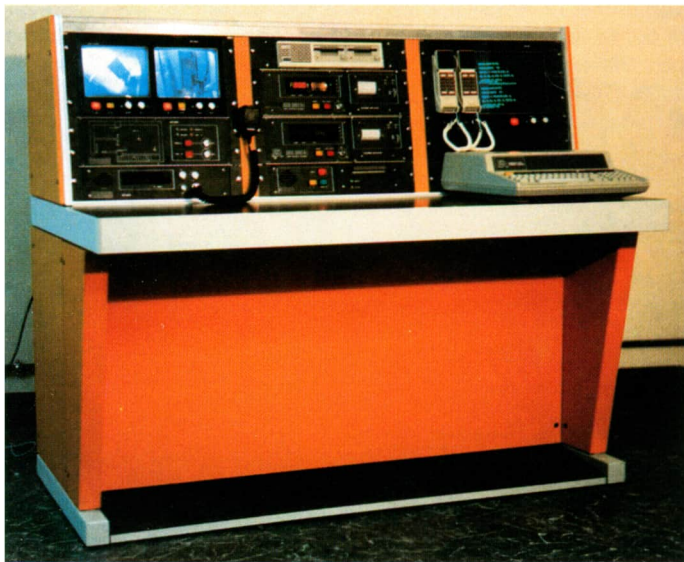
Sistema centralizado de alarmas vía radio. En una amplia consola puede tenerse información visual o sonora de los diversos puntos a proteger, además se pueden controlar los desastres de tipo atmosférico o la presencia de intrusos. (Cortesía: Tecno Data).
