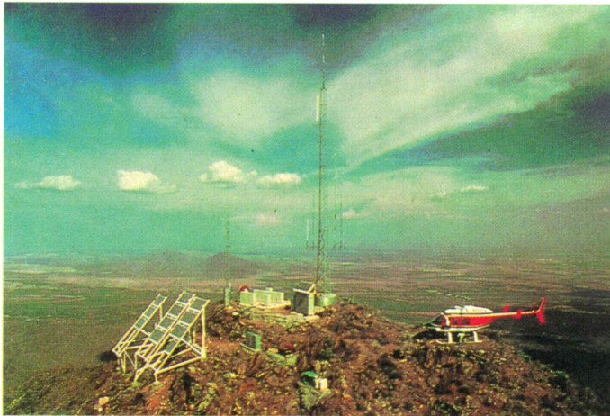
En las montañas de Sierra Estrella, Arizona, (EE.UU.), un sistema de 2 kWp alimenta un repetidor de radio de 50 canales de comunicaciones para uso privado.
