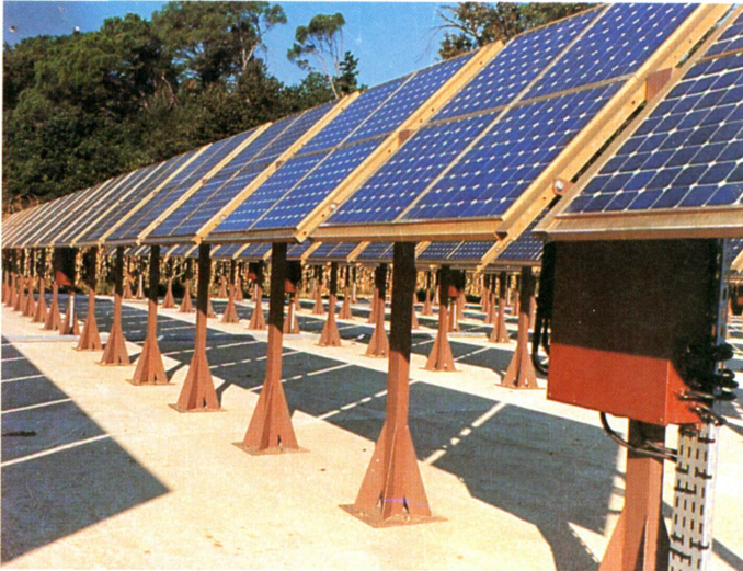
Aspecto que presentan los paneles solares de una central a base de células fotovoltaicas. (Cortesía: Isofotón - Málaga).
