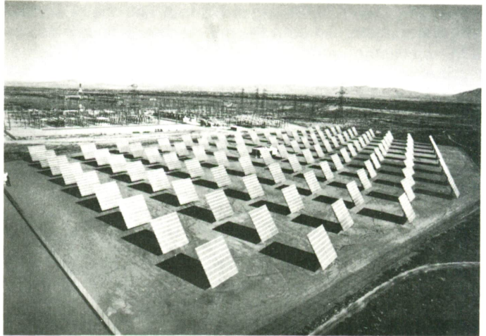
Central fotovoltaica de 1 MWp a base de acoplar un considerable número de paneles solares. (Cortesía: Arco Solar).
